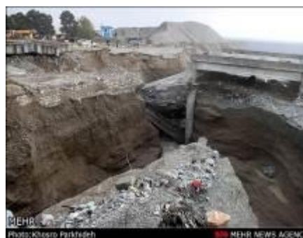
شکل (۱). تخریب پل در جاده قدیم کرج در اواخر آبان ماه سال ۱۳۹۱ (خبرگزاری مهر)
